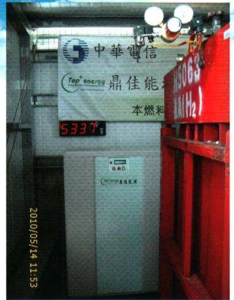
鼎佳能源於中華電信馬美機房 5kW燃料電池
