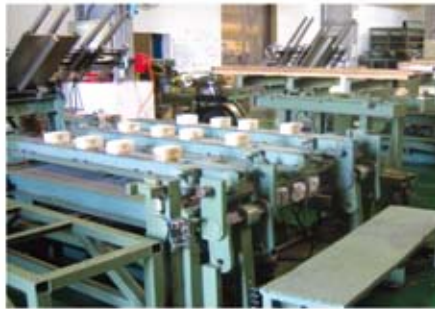
鐵心疊積設備
