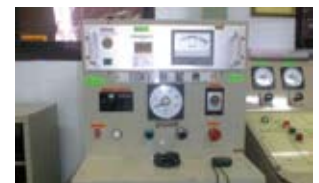
耐壓試驗設備
